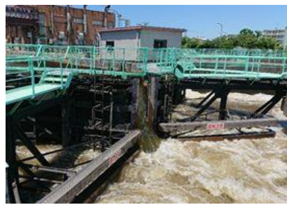
山の下開門排水機場
